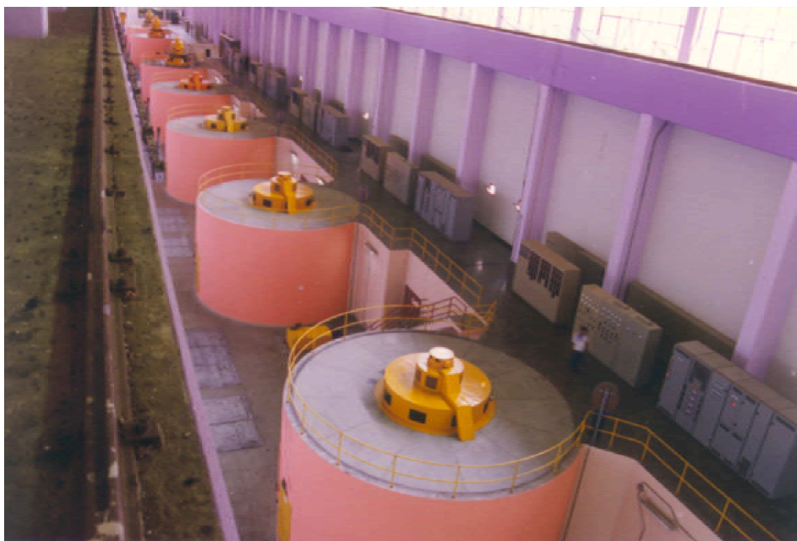
CENTRAL HIDROELECTRICA ANTUNEZ DE MAYOLO
