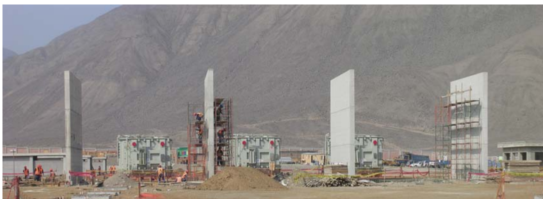
Vista Panorámica de los espacios para el transformador de potencia con muros corta fuegos - Subestación de Carabayllo - Patio de 500 kV
