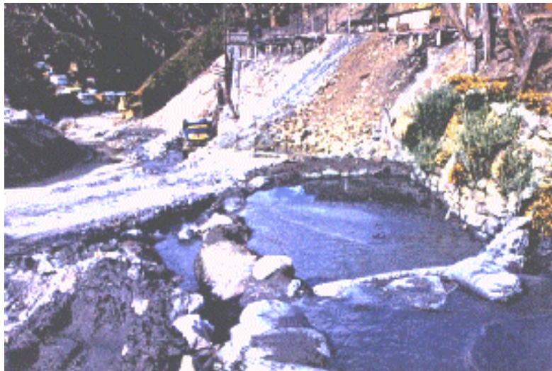
Descarga de agua de mina y tratamiento de sedimentos
