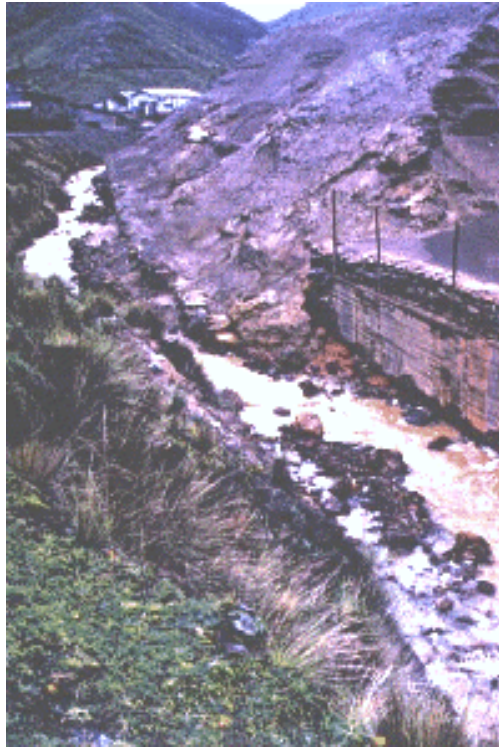
Falla de talud y filtración
